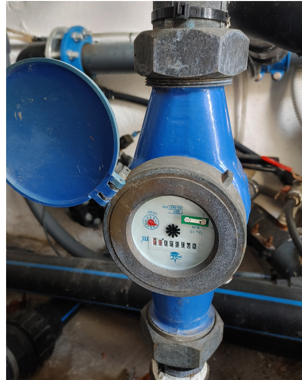
Esempio di contatore dell'acqua
